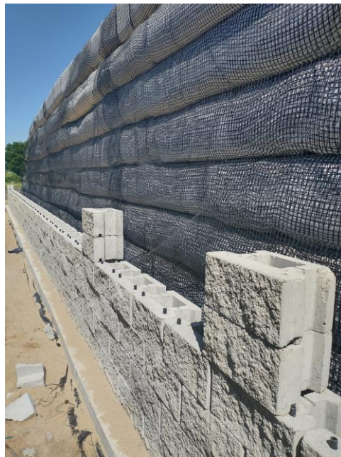
Rysunek 8 Mur w systemie biernym z oblicowaniem z bloczków drobnowymiarowych optemBLOK w trakcie budowy
