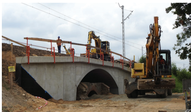
Fot. 5. Widok z boku na most w km 267,333 linii kolejowej E20 podczas budowy nawierzchni
