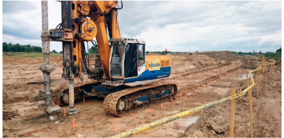
Fot. 6. Obiekt WS-22 – wykonywanie kolumn w technologii jet-grouting (fot. dzięki uprzejmości firmy Dragados)
