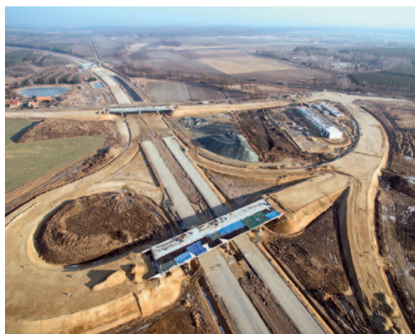
Fot. 2. Węzeł Krościna – Obiekty WD-16 i WD-16A (fot. dzięki uprzejmości GDDKiA O. Wrocław)
