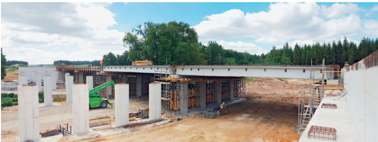
Fot. 3. Obiekt MS-25 – montaż prefabrykowanych belek typu T (fot. dzięki uprzejmości GDDKiA O. Wrocław)
