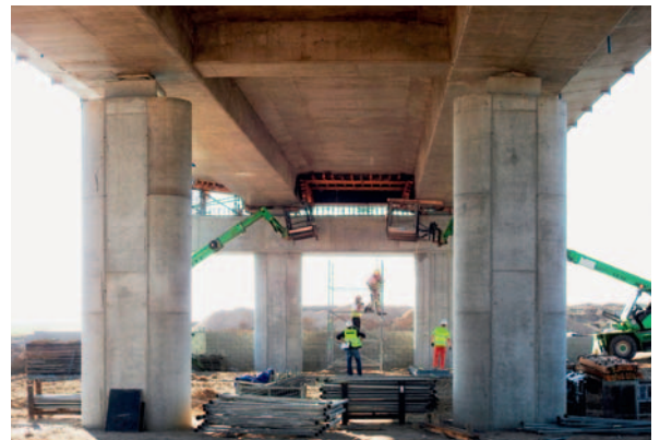
Fot. 12. Obiekt WD-13 – widok pomostu od spodu (źródło: materiały firmy Optem s.c.)
