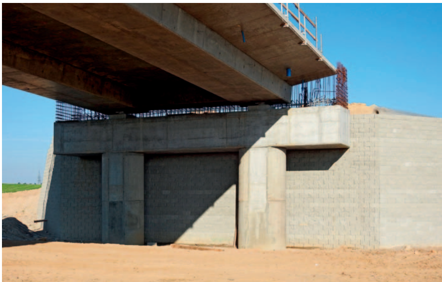
Fot. 13. Obiekt WD-13 – podpora skrajna oraz mury oporowe z gruntu zbrojonego optemBLOK (źródło: materiały firmy Optem s.c.)
