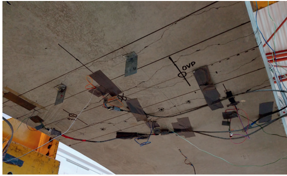
Rys. 7. Zarysowanie modelu LS1 w kluczu pod obciążeniem ok. 600 kN
