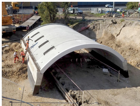
Rysunek 11. Obiekt na linii obwodowej Warszawy. Aktualnie w trakcie realizacji. Widoczne zamki zamiast płyty uciągającej
