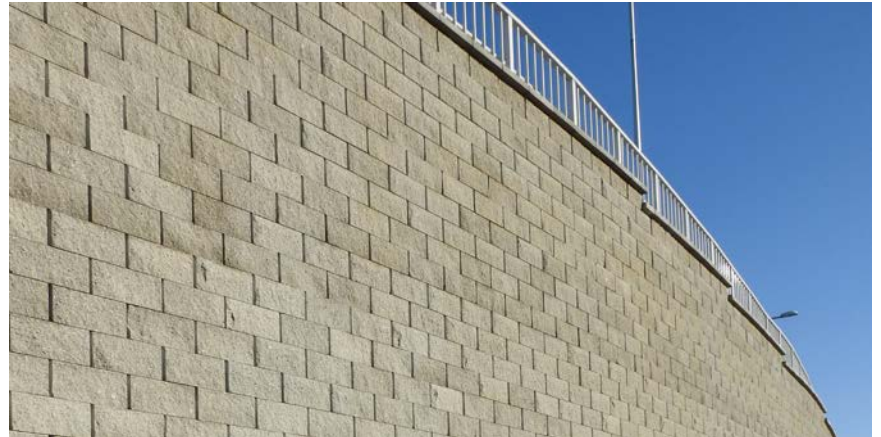
Fot.2. Wykorzystanie łączników pozwala na pozycjonowanie bloczków, dzięki czemu można uzyskać prostą i estetyczną powierzchnię lica muru (fot. Archiwum OPTEM sp. z o.o.)
